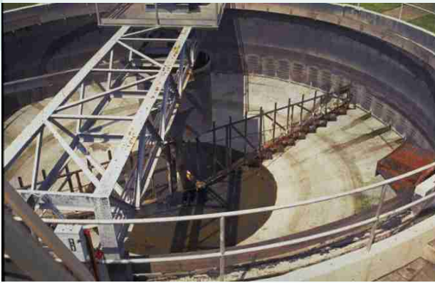
1 Se conoce como afluente el agua usada que llega a la planta de tratamiento
